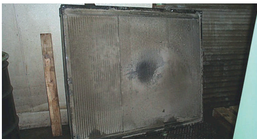
Behalve klemmende vlotterballen zorgen dichtgeslibde radiatoren van nakoelers en oliekoelers ervoor dat de temperatuur van de perslucht stijgt waardoor er meer vocht in het systeem wordt gebracht
